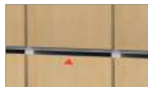
ANTA FESSURA PER DOCUMENTI
